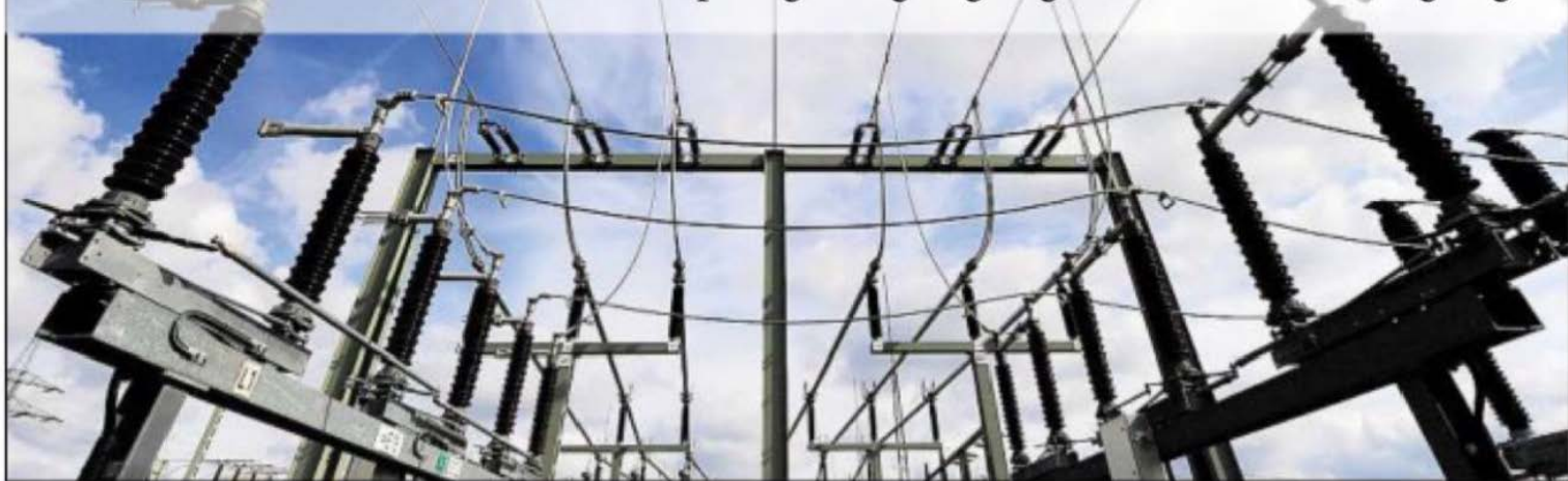
Die Umspannwerke benötigen enorme Flächen.
