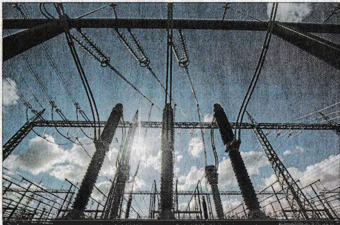
Wichtiger Punkt: Umspannanlage des Übertragungsnetzbetreibers Amprion in Wesel. Foto: dpa/Thissen
