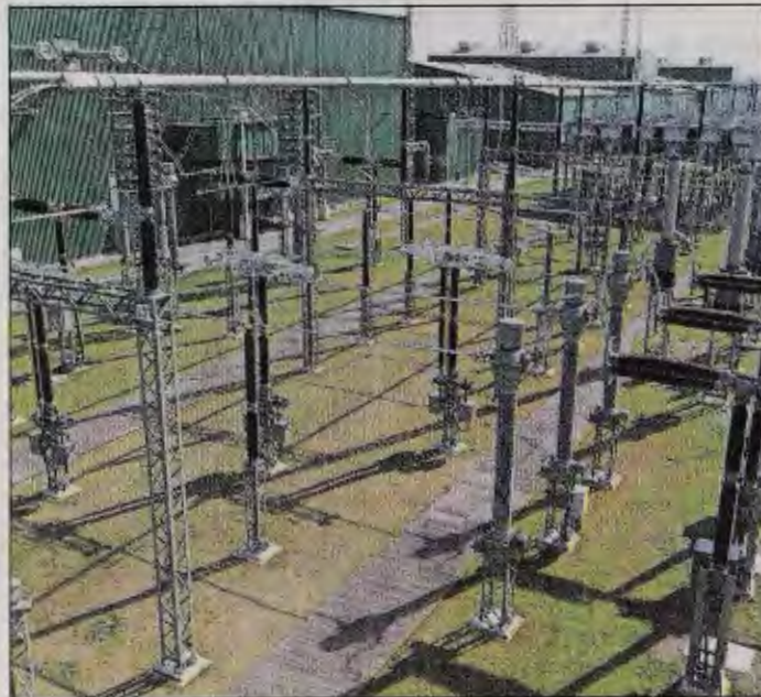
Umspannwerk in Dörpen/Emsland: Ähnliche Pläne verfolgt die Tennet für Nutteln und Garrel-Tweel. Foto: Tennet
