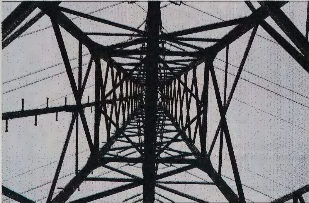
Nur einer von mehreren Streitpunkten: Die Tennet bevorzugt die Gittermasten. Mit Kompaktmasten würde aber weniger Fläche verbraucht.
