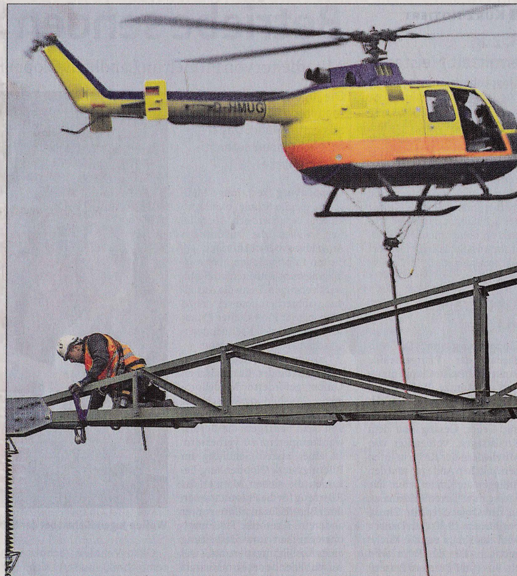
In luftiger Höhe: Die Strommasten sind bis zu 70 Meter hoch.
